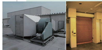
陽圧給気システム
