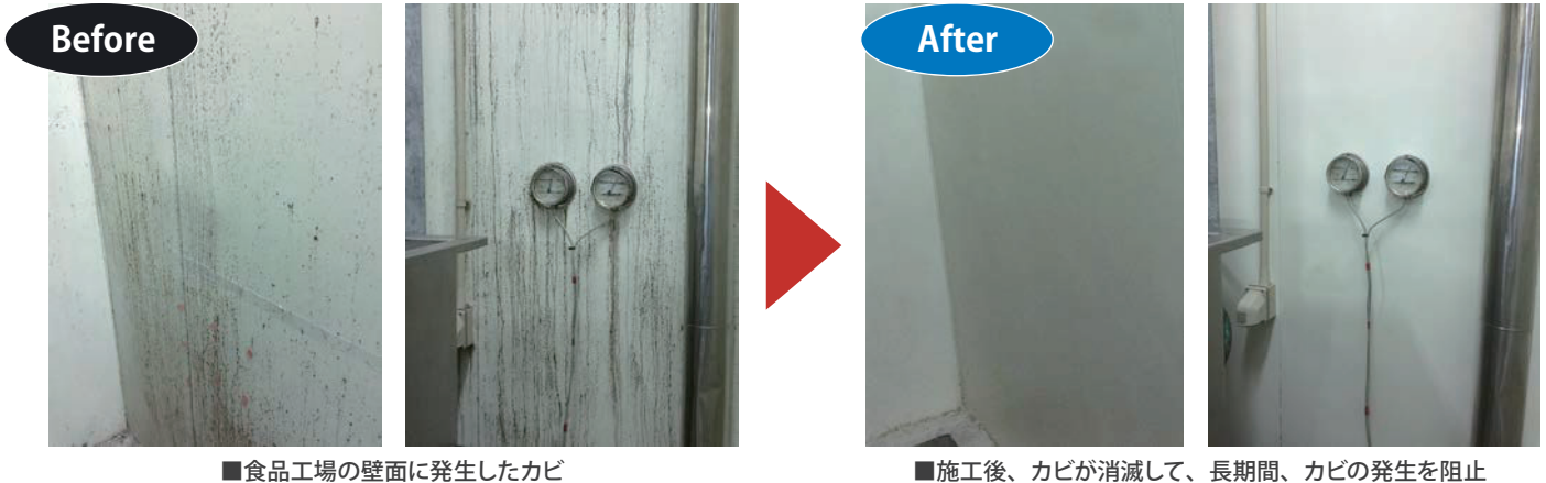
■食品工場の壁面に発生したカビ
